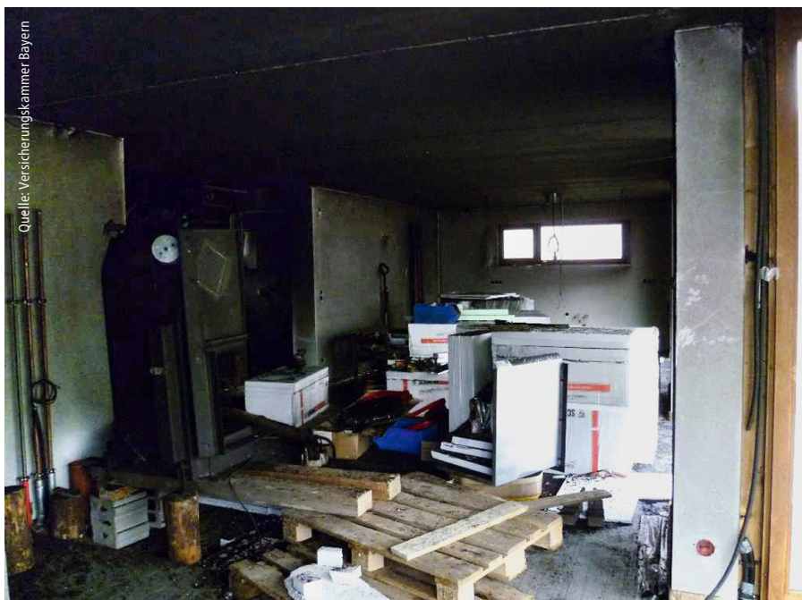
Abb. 5: Unkoordinierte Lagerung auf einer Baustelle
