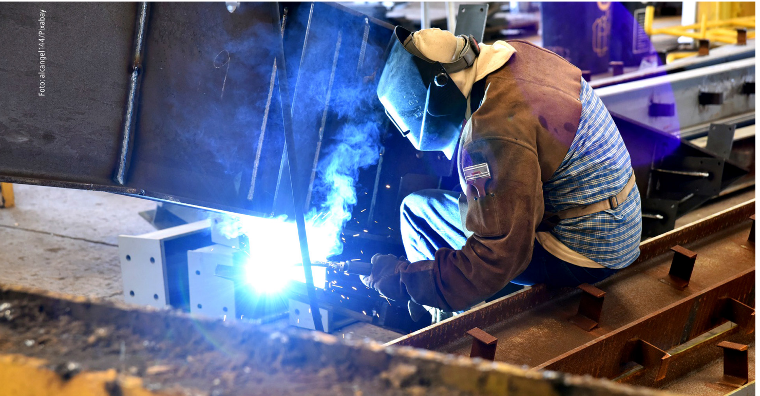
Abb. 1: Brandschutz auf dem Bau: Gebäude sind auch während der Bauzeit unzähligen Gefahren ausgesetzt.
