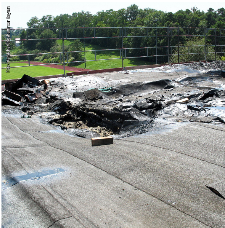
Abb. 3: Brandspuren auf der durch heißes Bitumen in Brand geratenen Unterkonstruktion eines Daches
