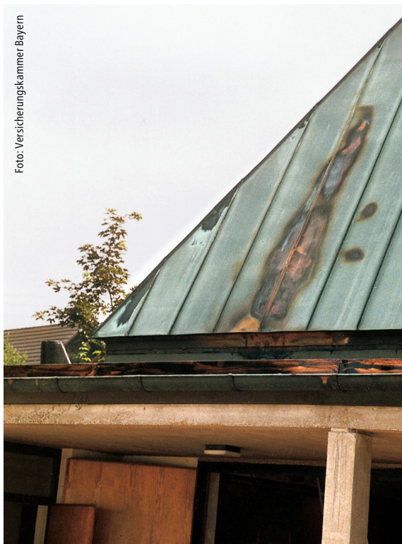
Abb. 2: Ein Großschaden infolge von Bitumen-Schweißarbeiten auf einem Dach
